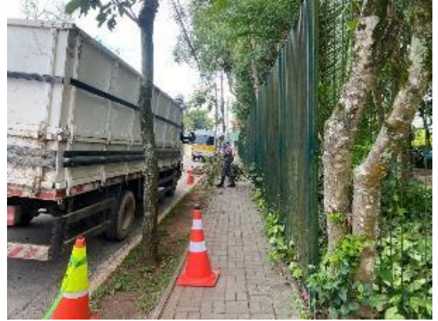
Figura 42: Poda realizada pela Enel perto da rede elétrica
