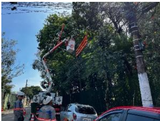
Figura 39: Poda realizada pela Enel perto da rede elétrica
