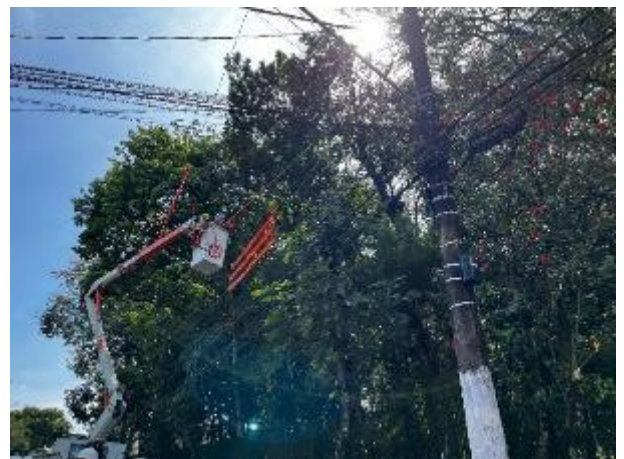
Figura 40: Poda realizada pela Enel perto da rede elétrica
