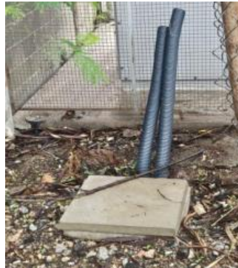
Caixas de passagem.
